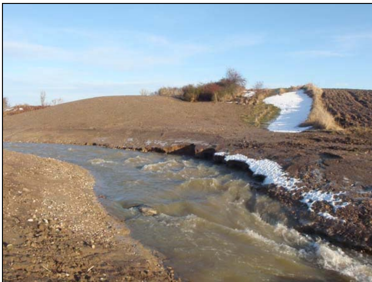
Foto 5.2 Åtgärdat parti vid högvatten med kraftig erosion (2009-12-29).
